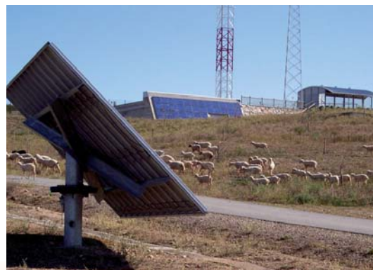
Figura 7.17. Campo fotovoltaico con seguidor solar
