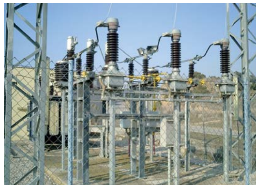
Figura 6.6. Punto de conexión en subestación transformadora
