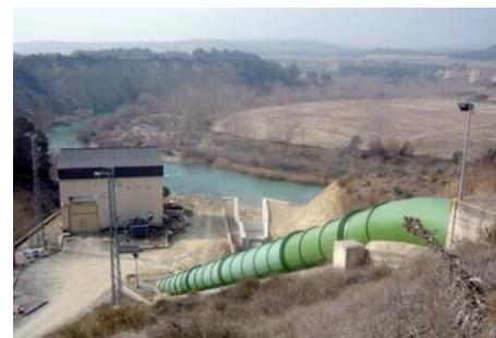
Figura 9.8. Tubería forzada en minicentral de Valdespartera, Zaragoza
