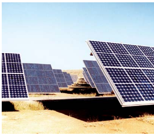
Figura 6.8. Huerta solar fotovoltaica
