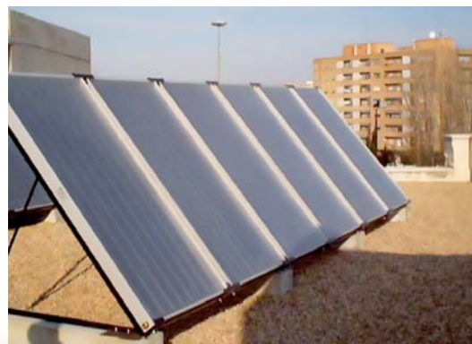
Figura 7.15. Colectores solares térmicos para agua caliente sanitaria en Zaragoza
