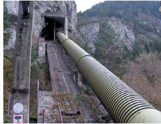
Figura 3.28. Tubería forzada. Central hidroeléctrica de Ip
