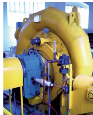
Figura 7.12. Turbina de una minicentral hidroeléctrica
